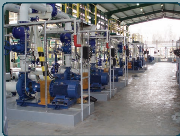
SEPRO a.s., ЦЕНТРАЛЬНАЯ НАСОСНАЯ СТАНЦИЯ ROUDNICE – БЕНЗИН, ДИЗЕЛ, НАСОСЫ ТИПА CSI
