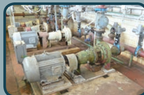
UNIPETROL RPA s.r.o., ХОЗЯЙСТВО ОТБРОСА, НАСОСЫ ТИПА CSX, ЭКСПЛУАТАЦИЯ С 1972 Г.
