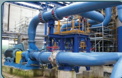
GPN S.A., [FRANCIE] ПРОИЗВОДСТВО АЗОТА НАСОСНЫЕ АГРЕГАТЫ, ТИПА CSO C ЭЛЕКТРОДВИГАТЕЛЕМ 500 KW, 5500 V
