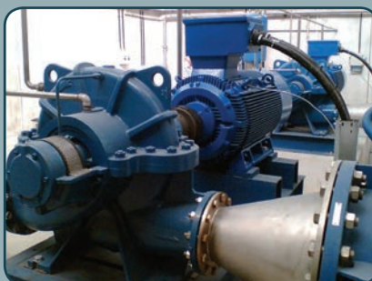
PRAŽSKÉ VODOVODY A KANALIZACE a.s., ОСНОВНЫЕ НАСОСЫ, НА НАСОСНОЙ СТАНЦИИ LIVEN. НАСОСНЫЕ АГРЕГАТЫ CDS С ЭЛЕКТРОДВИГАТЕЛЕМ 315 KW
