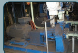
VÍTKOVICE a.s., ПОДВЫШКА НАПОРА В ПРОЦЕССЕ НА 80 BAR, НАСОСНЫЙ АГРЕГАТ ТИПА CSA, УЛОЖЕНИЕ OG2
