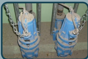
TŘINECKÉ ŽELEŽÁRNY a.s., PLANT Kladno, WATER WITH SCALES, PUMPS CSX-S SERIES
